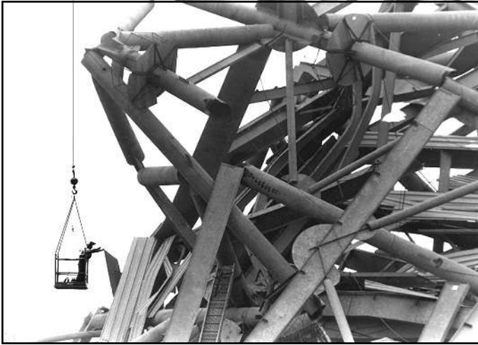
Рис. 29-1. Навес над футбольным стадионом Вашингтонского университета обрушился, не выдержав собственного веса во время строительства. Он скорее всего был бы достаточно прочным после завершения работ, но строительство велось в неправильном порядке — налицо ошибка интеграции
